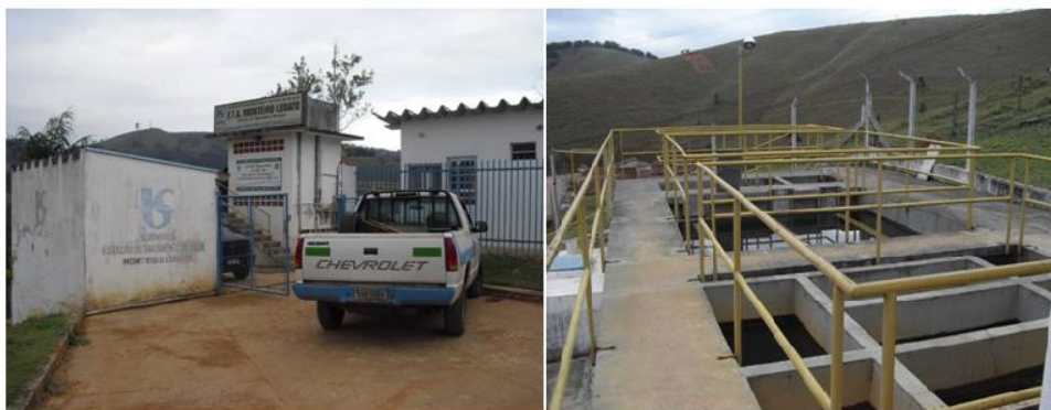
Foto 10: Entrada da ETA em Monteiro Lobato e os tanques de tratamento da água.
