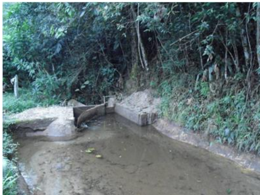
Foto 08: Sistema de captação superficial no Córrego Serrinha, município de Monteiro Lobato.
