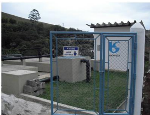
Foto 13: ETE da sede municipal de Monteiro Lobato. Fonte: São Paulo (2010a)
